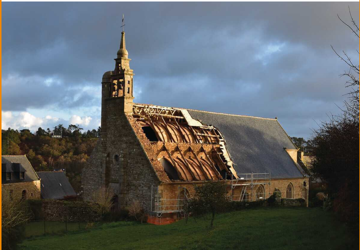
La chapelle du Yaudet à Ploulec'h (22), après le passage de la tempête Ciaran © Hamel Géomètres Experts
